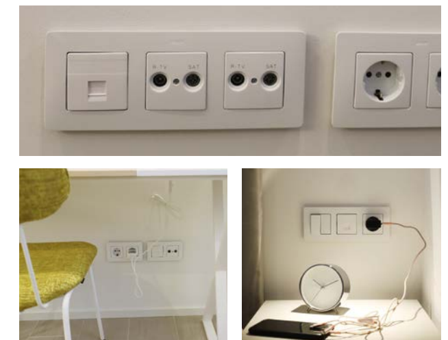
TV y datos en cocina, salón-comedor y habitaciones
